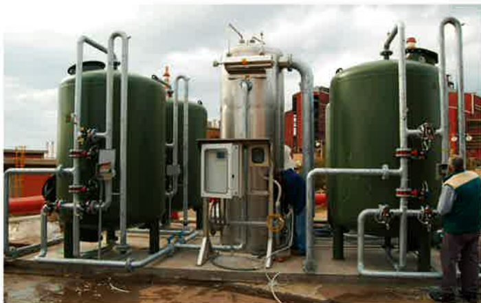
Immagine 8: impianto di filtrazione su sabbia
