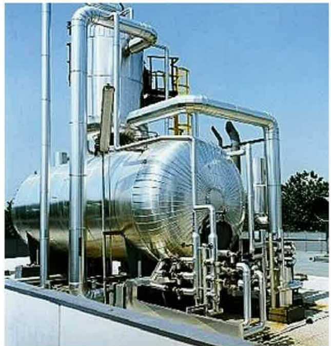
Immagine 12: degassatore per impianti boiler
