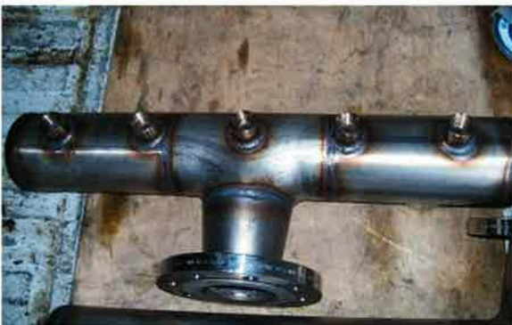
Immagine 6: Tubo di acciaio inox con evidenti segni di saldatura.
