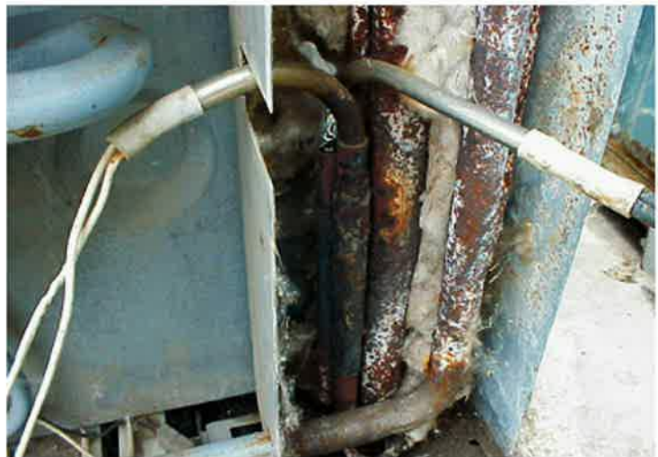
Immagine 11: particolare di un boiler danneggiato
