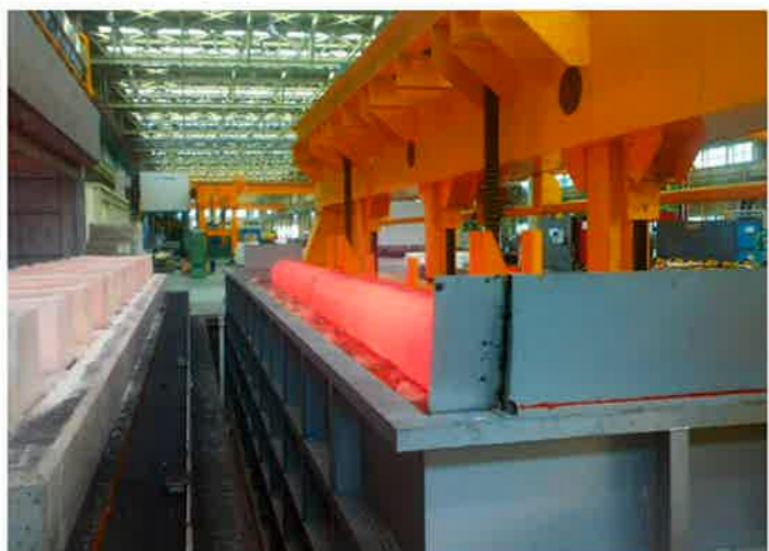
Immagine 28: impianto di solubilizzazione per tubi
